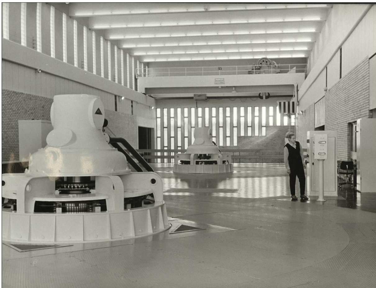
МОМ ОФ-15435/2430-56а. ГЭС Хевоскоски. Машинный зал. 1971 г.
